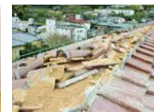
壊れた屋根瓦
