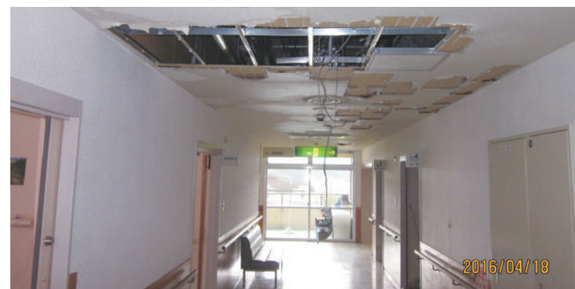
漏水被害のあった東棟
