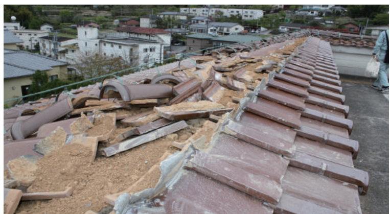
壊れた屋根瓦
