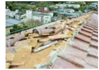
壊れた屋根瓦
